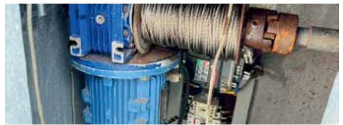
งานมอเตอร์ขับเคลื่อนระบบอัตโนมัติ
